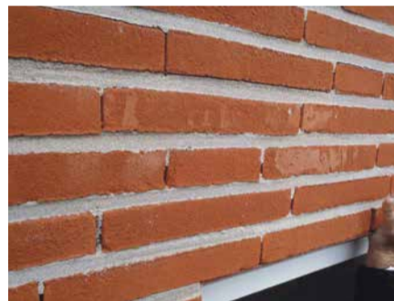
Horizontale scheuren boven kozijn.
