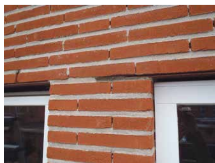
Horizontale scheuren boven penant.
