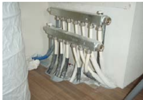
Doorvoer CV leidingen schacht.
