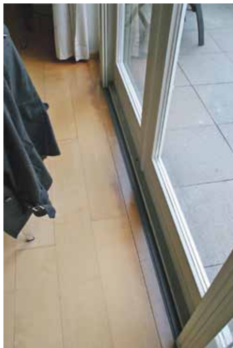
Verkleuring parketvloer bij gevelkozijn.
