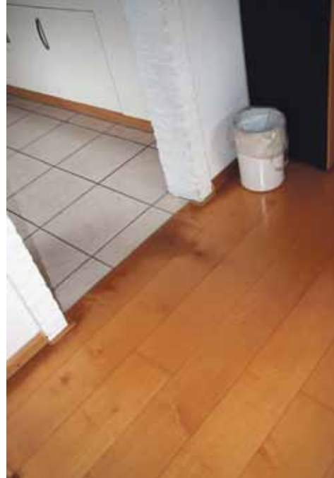
Verkleuring parketvloer bij overgang keukenvloer.
