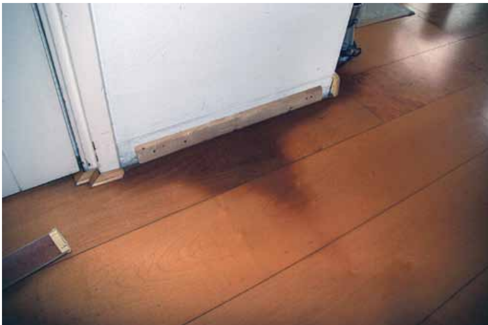
Verkleuring parketvloer bij dragende wand.
