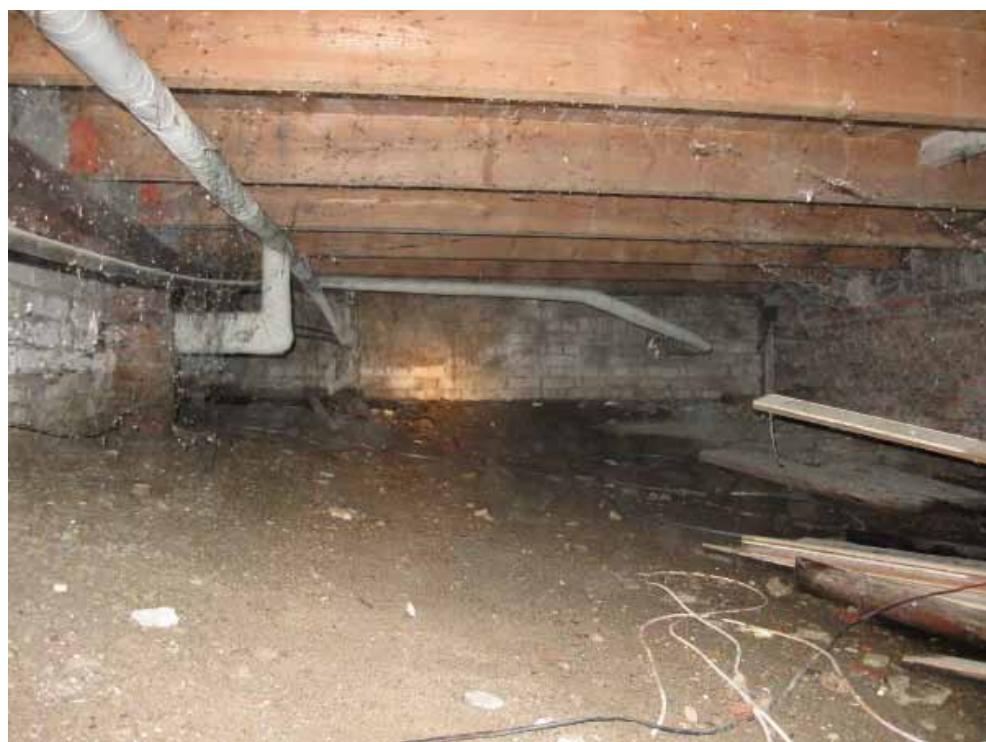
Foto 1. In de kruipruimte is de betonnen bodemafluiting verzakt en in het midden gebroken.
