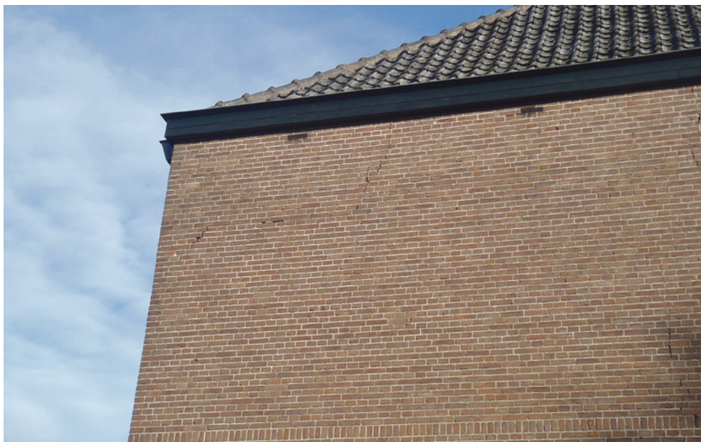
Diagonale scheuren in de linker zijgevel.
