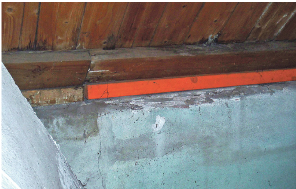
Slechte reparatie van de muurplaat.
