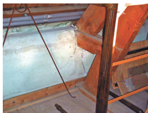
Scheuren ter plaatse van de blokkelen.
