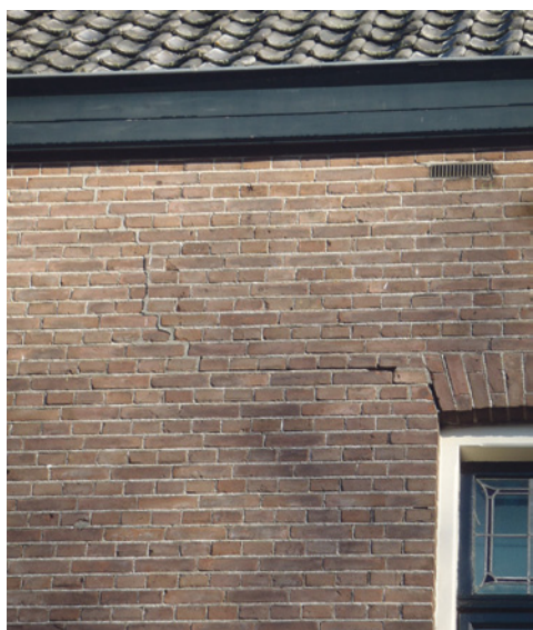
Diagonale scheuren in de linker zijgevel.
