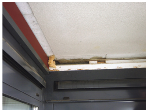
Lekkage bij de onderburen.
