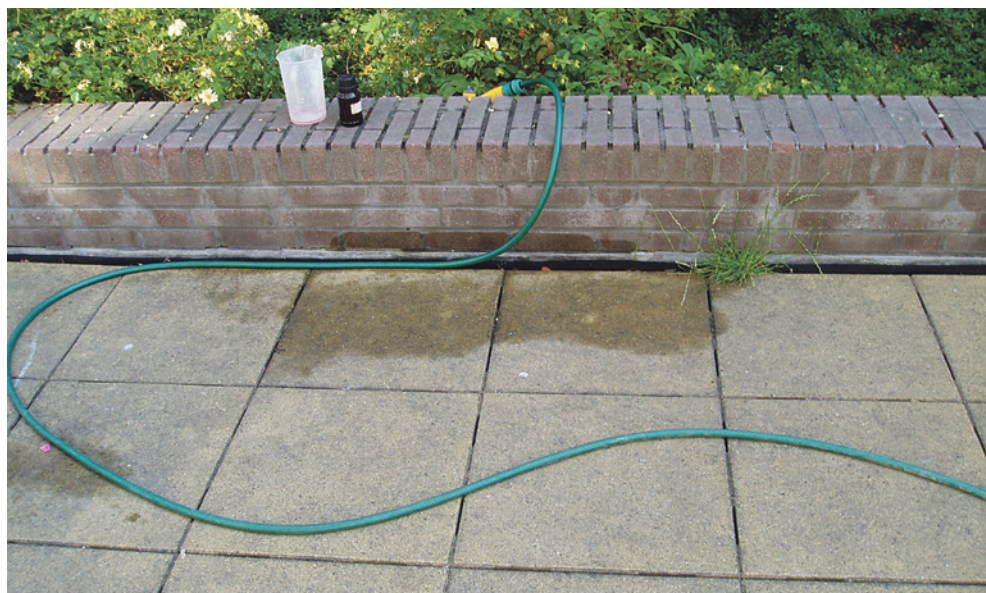
Berekeningstest waarbij het doorlekkelen van de scheidingsmuur duidelijk zichtbaar wordt.
